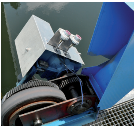
Lubrificação de rolamentos através de tubos num purificador secundário.
