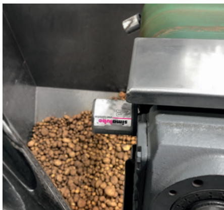
Duas unidades simalube 60 ml lubrificam os rolamentos do rolo deflector de um tapete transportador no processamento de batata.
