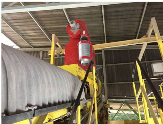
Instalação em silo
