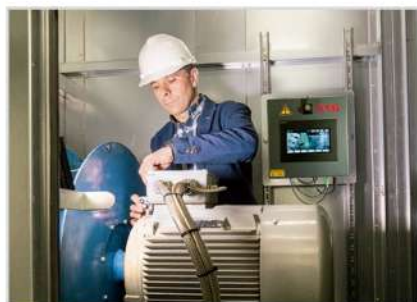
Monitorização online de motor e ventilador
