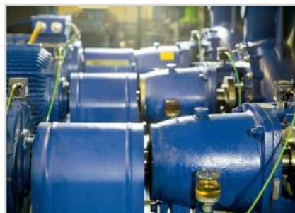
Monitorização online de motor e bomba
